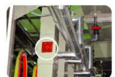
電鍍排廢汽管異常溫度例測 (上村按裝實例)
