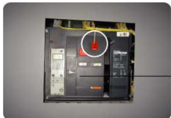
VCB過載異常溫度偵測
