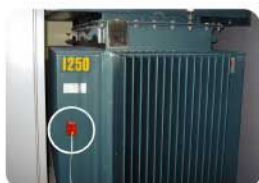
變壓器異常溫度偵測
