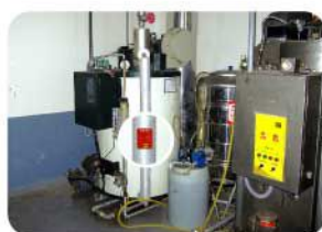
蒸汽管異常溫度偵測
