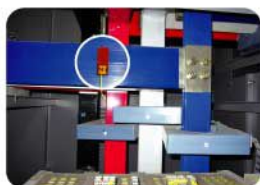
電力匯流排異常溫度偵測
