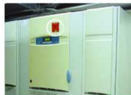
UPS房溫度偵測
