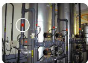
蒸汽管異常溫度偵測
