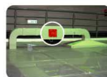
排廢汽管異常溫度偵測 (上村按裝實例)
