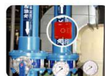
冷氣管異常溫度偵測 (上村按裝實例)
