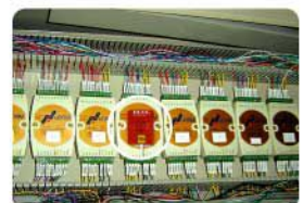
通信環控室異常溫度偵測
