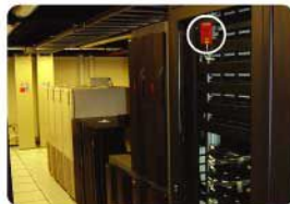
通信機房異常溫度偵測
