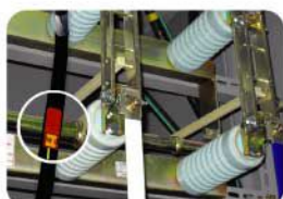
高壓大電纜異常溫度偵測
