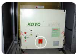
大型UPS異常溫度偵測
