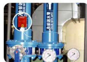
冰水機管路異常溫度偵測
